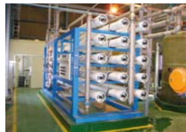
Dongbu Steel Wastewater Reuse Site
